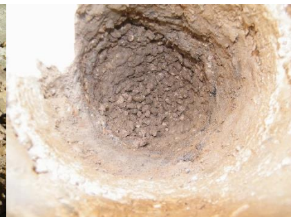
Présence de graviers en fond
