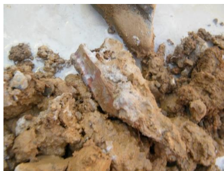
Présence de brique dans le remblai
