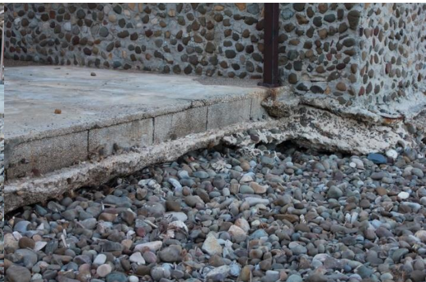
Affouillement de la terrasse côté Ouest
