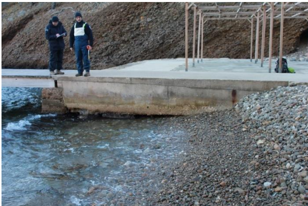
Affouillement de l'extrémité de la terrasse (janvier 2018)
