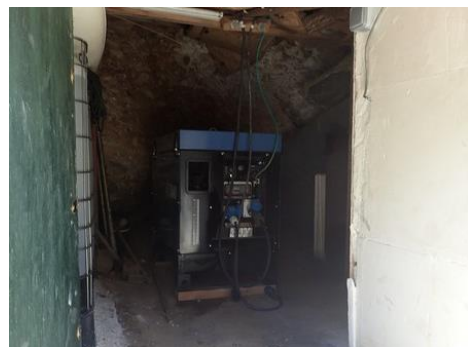
Vue de la pièce où se situe le groupe électrogène
