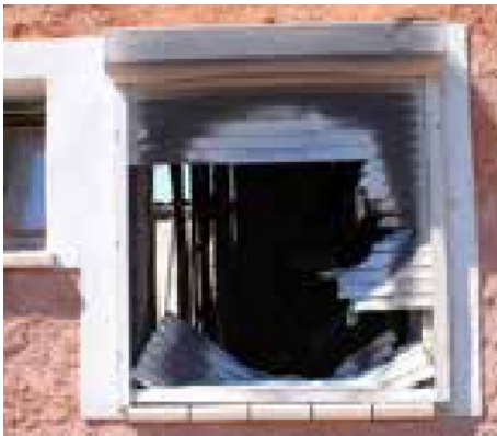
Les volets en PVC fondent sous la chaleur
