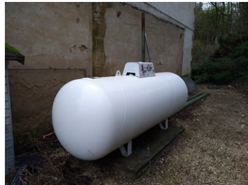
Les citernes d'hydrocarbures non enfouies peuvent exploser
