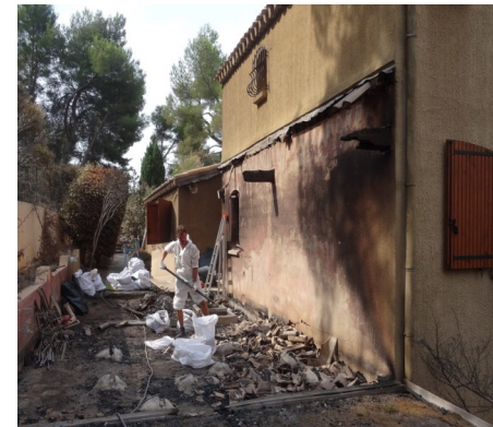
Les poutres extérieures apparentes sont un vecteur de propagation du feu à l'habitation
