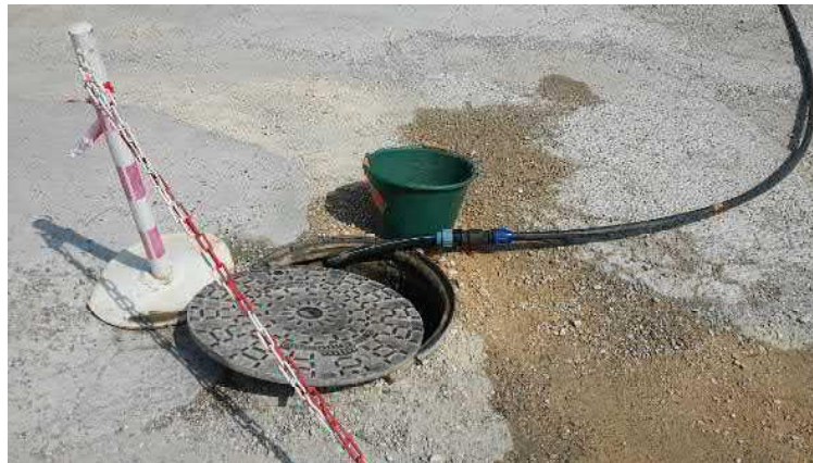
Figure 16 : Rejet des eaux d'exhaure dans le réseau d'assainissement
