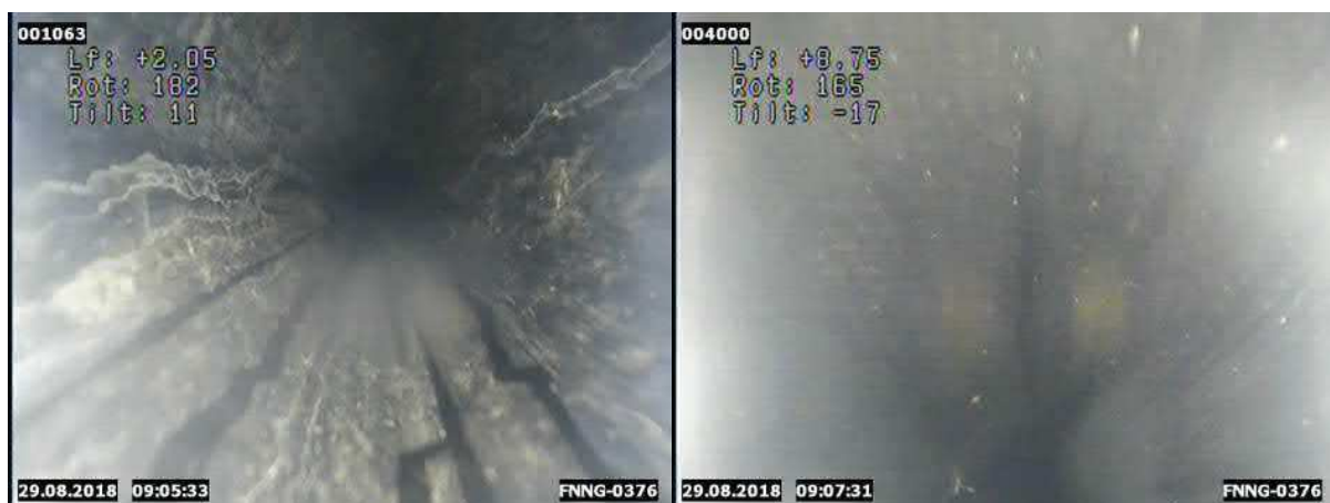
Figure 6 : Zone émergée : coulures sur la paroi intérieure du tubage
