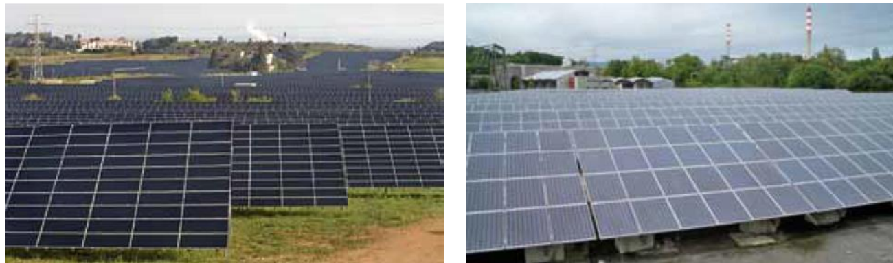
Photo 2 : installations fixes au sol (Guide de l'étude d'impact 2011)
