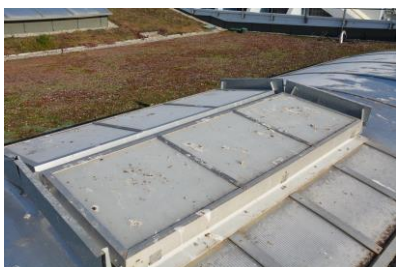
Bât F3 Puit de lumière totalement souillé
