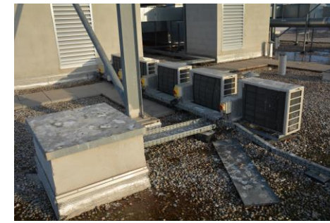
Bât F3 Blocs climatisation souillés de fientes
