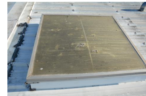
Bât k2 Puits de lumière percé à coups de becs et colmaté au mastic
