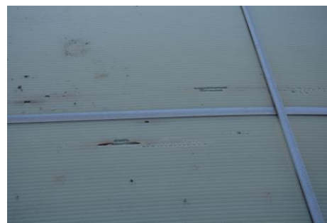
Bât E2 Puits de lumière percé à coups de becs
