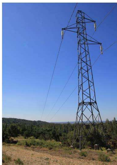
Photo 16 : Ligne électrique sur l'aire d'étude immédiate et pylône
