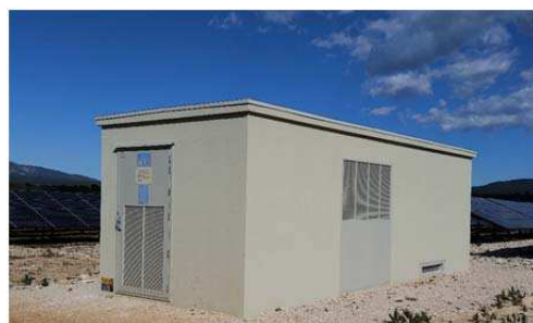
Photo 4 : Exemple de poste de transformation
