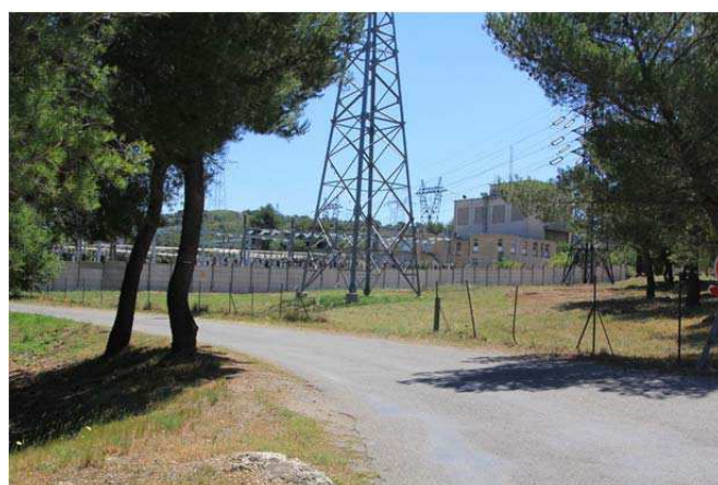
Photo 17 : Poste électrique de Roquerousse
