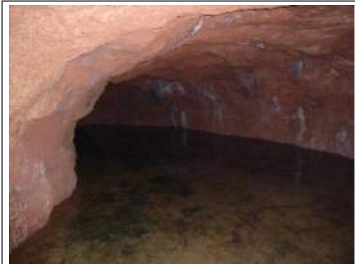
Réseau souterrain Viaud Ricaud (non Rondani)
