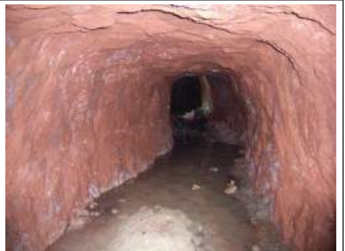
Réseau souterrain Viaud Ricaud (non Rondani)
