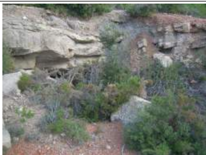
Effondrement localisé D4 donnant accès à une petite zone exploitée au bout de la galerie GMO4
