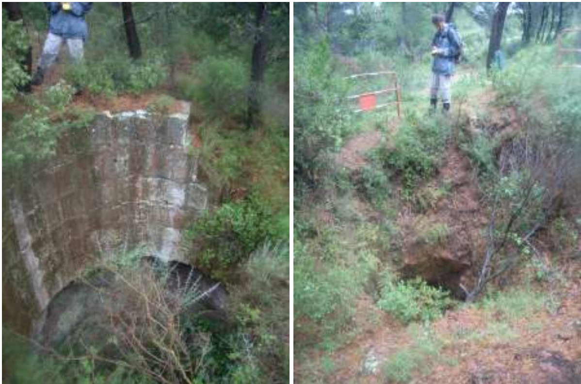
Figure 23 : deux puits ouverts sur le secteur du Parisot, INERIS
