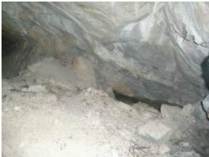
Chute de toit, galerie de recherche GMO5
