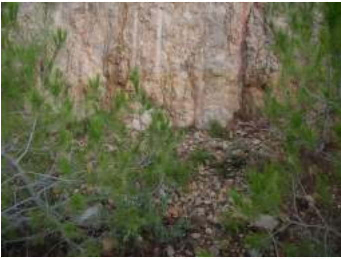
Peu d'éboulis en pied du flanc nord
