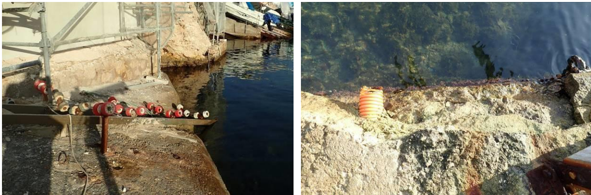
Exemples de dégradations observées sur le glacis Sud-Ouest
